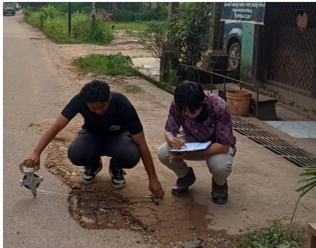
Gambar 3. Pengukuran Kerusakan Aspal
